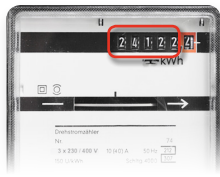
Elektriciteitsmeter met één telwerk
